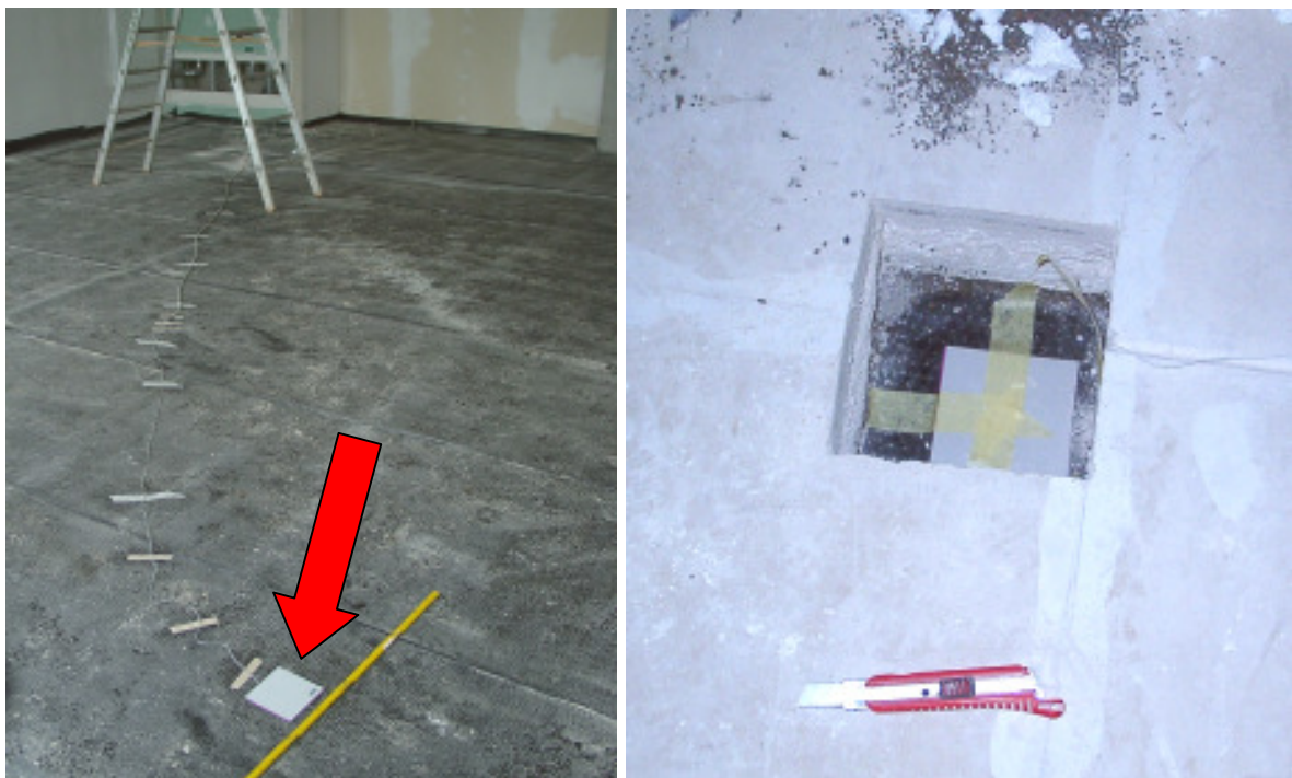
Abbildung 23: Montage der Wärmestrommessplatten in Raum 0.3 (vor dem Einbringen der Dämmung) und im Bodenaufbau im Flur vor Raum 0.3.
