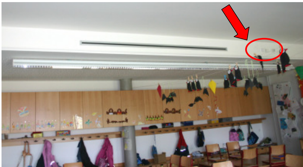
Abbildung 18: Klassenraum mit der Sensorplatte rechts neben dem schlitzförmigen Zuluft-Ventil.
