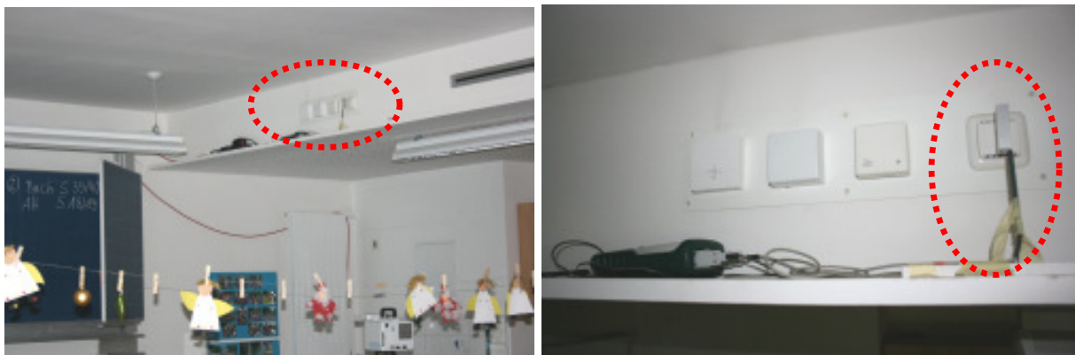
Abbildung 26: Dauerhafte M-Bus-Temperaturmessstelle in 2,94 m Höhe im Klassenraum 0.3 während der Vergleichsmessung mit einem Datenlogger.
