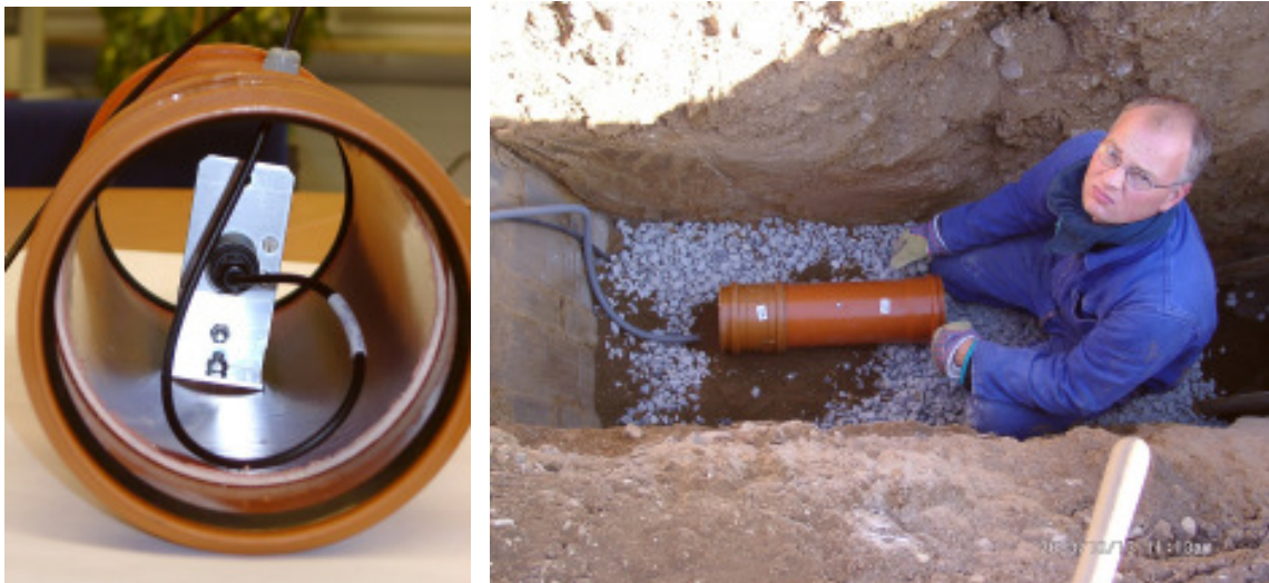
Abbildung 20: Sensor zur Messung der relativen Feuchte im Erdreich. LINKS: Im Kunststoffschutzrohr montierter Sensor. RECHTS: Montage des Sensors im Bereich unter der späteren Bodenplatte, etwa auf Höhe des untersten Fußpunktes der Dämmschürze.
