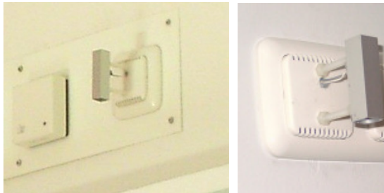
Abbildung 17: LINKS: Sensorplatte in einem Klassenraum an der Stirnseite der Deckenabkofferung mit einem Feuchte- und einem Temperatursensor. RECHTS: Einzelner Temperatursensor mit Strahlungsschutzrohr.
