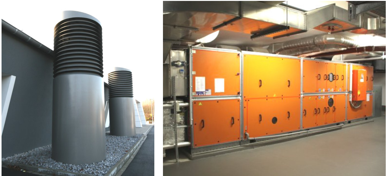
Abbildung 20: Lüftungstürme für die zentrale Außen- und Fortluft aller sechs Lüftungsanlagen (Links) und Lüftungsgerät „Umkleiden/Duschen“ im Keller (rechts)
