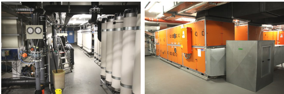
Abbildung 12: Wassertechnik (Filter) im Keller (links) und Lüftungsgeräte im Keller (rechts)
