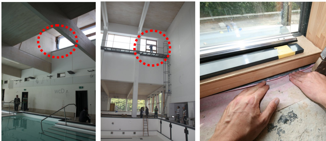
Abbildung 13: Beispiele für die Leckagesuche bei 50 Pa Unterdruck im Bereich der Dachgaube (Halle 1+2) (links) und an den Fenstern im oberen Bereich von Halle 5 (mitte) sowie die abgelöste Verklebung an der Abdichtung der Pfosten-Riegel-Fassade zur Brüstung (rechts)
