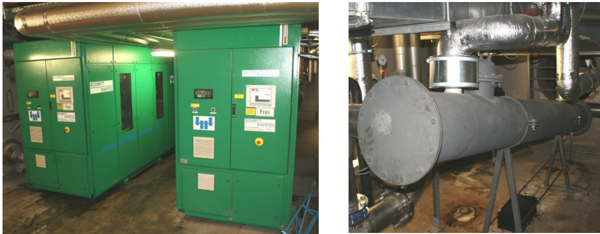
Abbildung 17: Heizungsraum im Keller (Altbaubereich) mit den beiden BHKW-Anlagen (links) und einem der beiden Abgaswärmetauscher (rechts)
